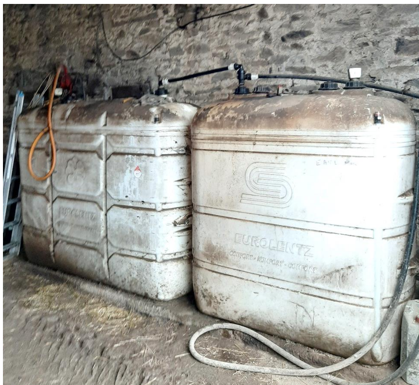
Vue H : Cuves à fuel présentes sur le site
